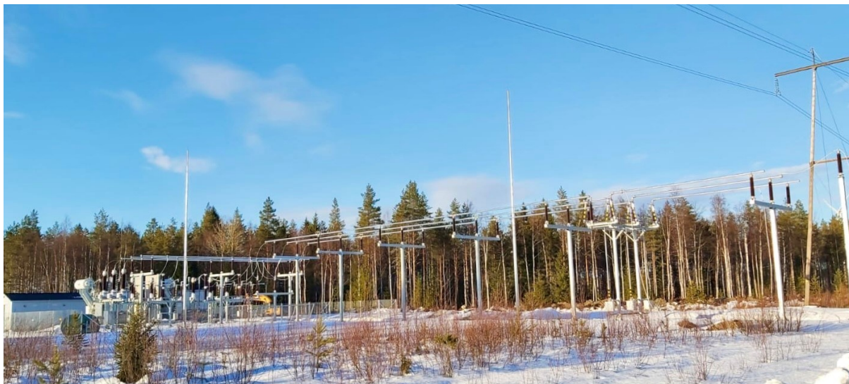
Kuva 3-2. Tuulivoimapuiston sähköasema (© ELTEL Networks Oy).
